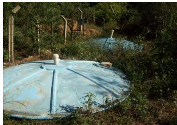
Figura 33: Sistema de tratamento da ETE de Queluzito.
