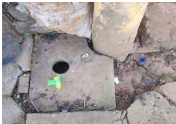
Figura 83: Caixa de passagem / coletora de águas da limpeza e pluvial (direita da área de recepção).
