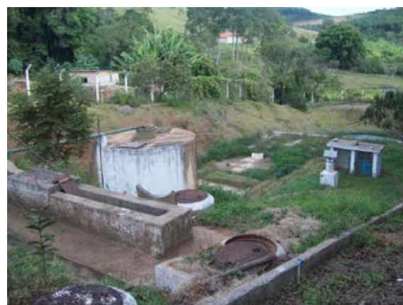
Figura 31: Vista geral da ETE do município de Carandaí.
