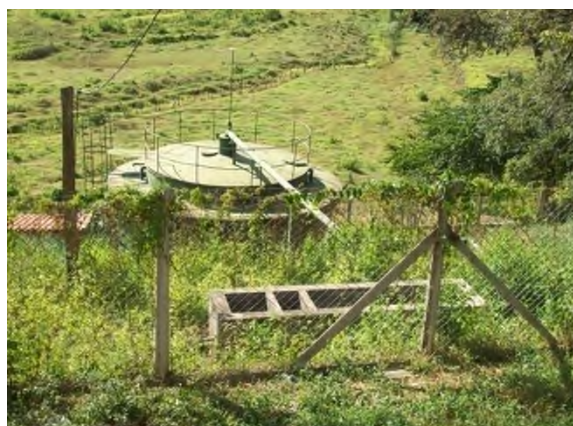
Figura 38: Vista geral da ETE Santana dos Montes.
