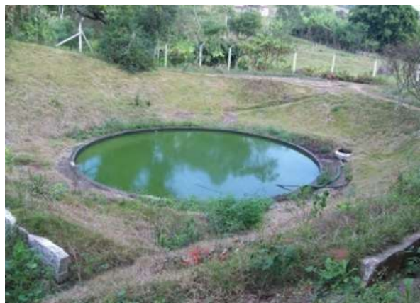
Figura 29: Lagoa anaeróbia da ETE de Carandaí.
