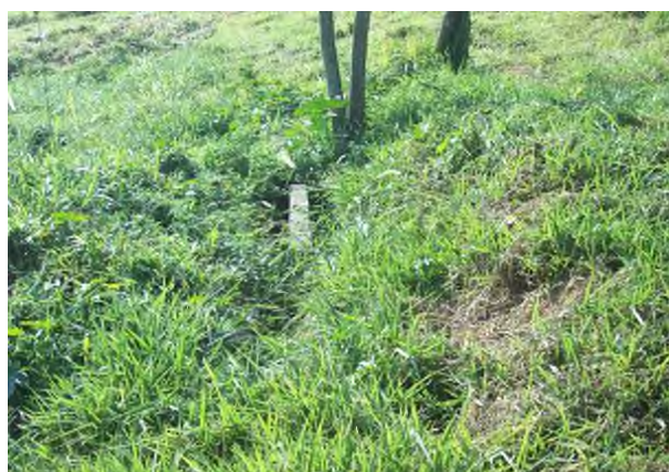
Figura 23: Tratamento preliminar da ETE de Caranaíba em condições precárias de manutenção.
