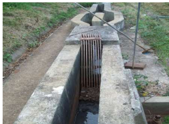
Figura 26: Sistema de tratamento preliminar da ETE de Carandaí.
