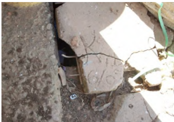
Figura 82: Caixa de passagem / coletora de águas da limpeza e pluvial (esquerda da área de recepção).
