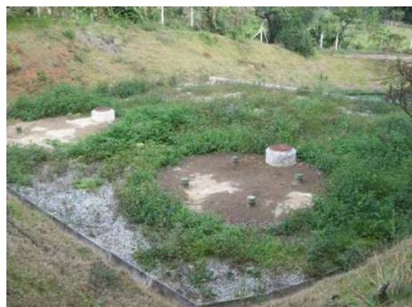
Figura 28: Filtro anaeróbio da ETE de Carandaí.
