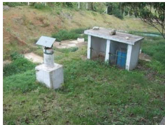
Figura 30: Queimador de gases da ETE de Carandaí.
