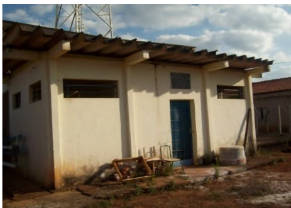
Figura 17: Estação de Tratamento de Água do município de Casa Grande.
