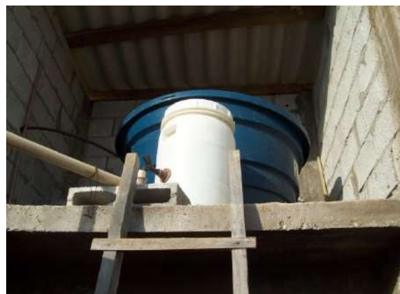
Figura 18: Tratamento de água do município de Casa Grande.
