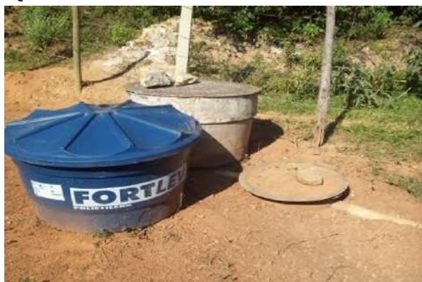
Figura 35: Recipientes utilizados para acumulação dos resíduos sólidos gerados na ETE de Queluzito.
