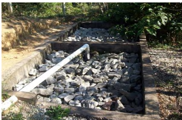
Figura 34: Sistema de tratamento da ETE de Queluzito.
